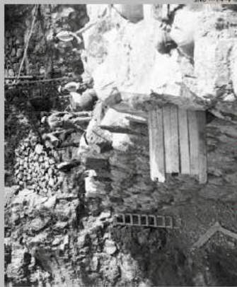
Construction du barrage de la Pierra Bessa, ici entre le 30 juillet et le 08 octobre 1937. Building the Pierra Bessa Dam between the 30th July and 8th October 1937.
