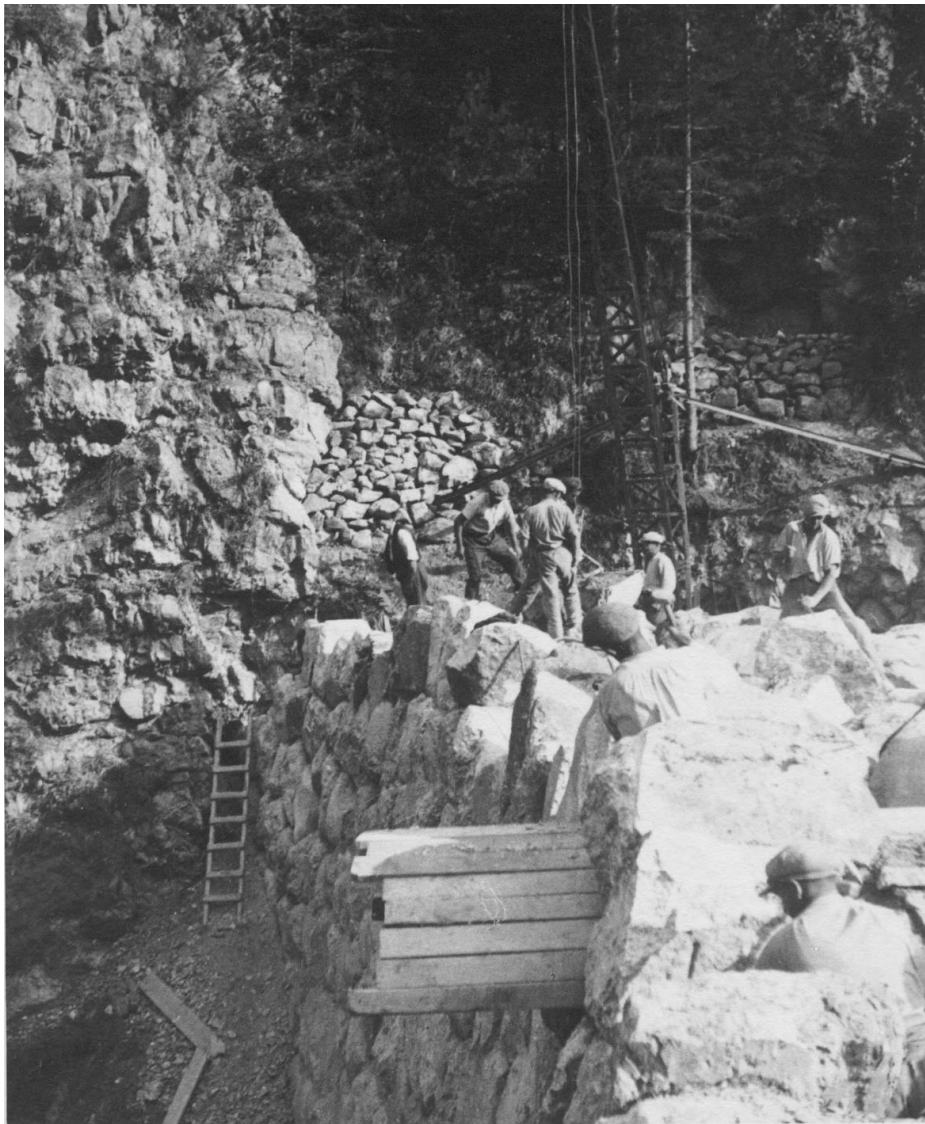
PERIMETRE DES DRANSES - SERIE DE VAILLY - TORRENT DU BREVON Barrage de Pierra Besse en construction
